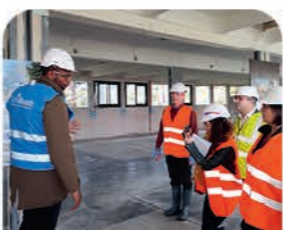
10 NOVEMBRE Visite du chantier de l'internat du lycée Dupuy de Lôme à Brest
